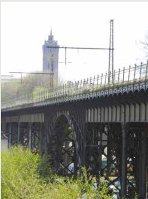
Menacé de démolition, le viaduc de Chemnitz fait l'objet d'une mobilisation citoyenne en faveur de son maintien. (© Eugen Brühwiler)
