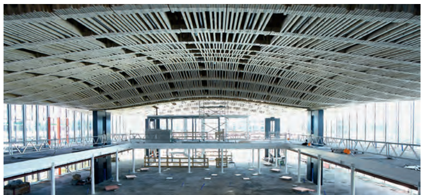
Blick in das vollständig BIM-gestützt geplante «Arch_Tec_Lab» der ETH Zürich.
