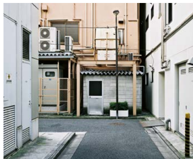
Darf's ein bisschen mehr sein? Haustechnik in Tokio.
