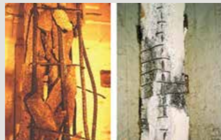
Réduction de l'écaillage par le resserrement des étriers bien ancrés (Photo Walter Borgogno)
