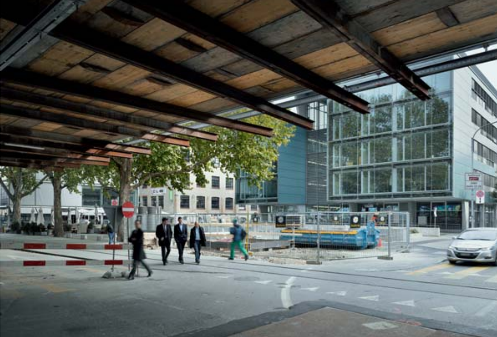
01 An der Hardstrasse im Zürcher Industriequartier, wo die Hardbrücke saniert und eine neue Tramlinie gebaut werden (Fotos: Hannes Henz)
